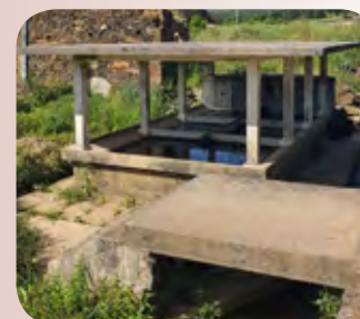
Tanque de Sobreço
